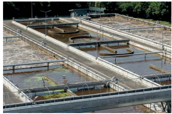
正在污水处理厂中使用的HOMA的潜水搅拌机
